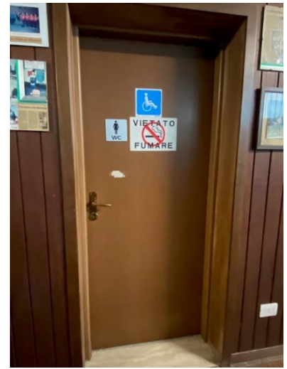
Porta bagno disabili
